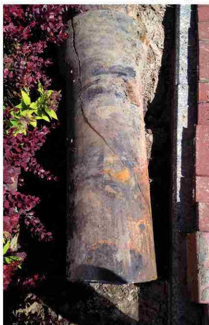
Pęknięta rura z ulicy Traugutta
