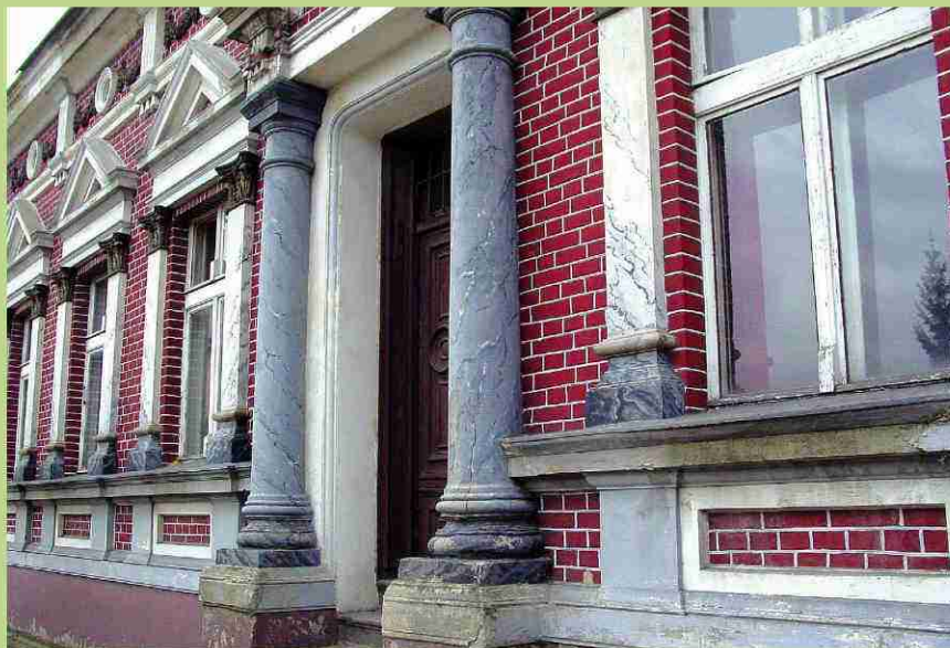
Dom B. Gutowskiego - stan sprzed remontu (2002 r.)
